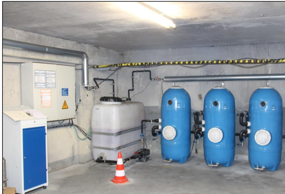
Beispielfoto Aktivkohlefilter zur Grundwasserreinigung
